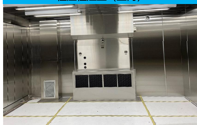
恒温恒湿室 (室内)
