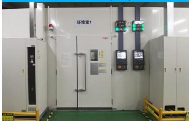
恒温恒湿室 (2间)
